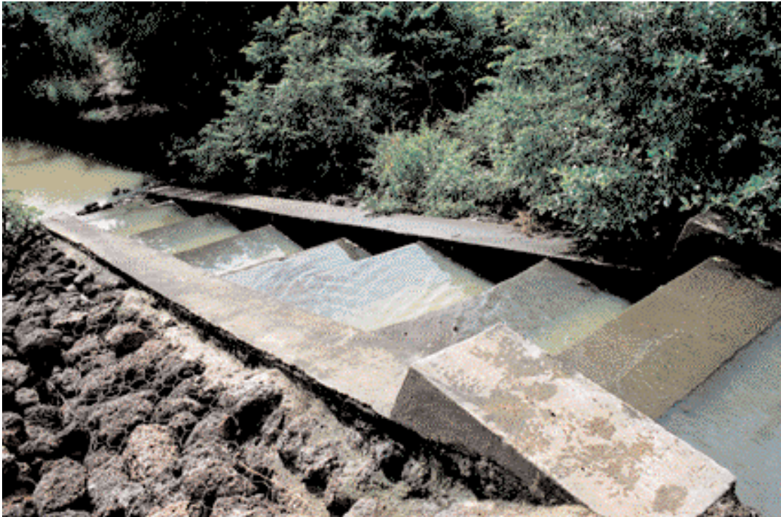
ជណ្តើរត្រីអាចឱ្យត្រីធ្វើចរាចរឆ្លងកាត់ទំនប់ស្រោចស្រព (Burkina Faso)។ ជណ្តើរត្រីជាការកែលម្អហេដ្ឋារចនាសម្ព័ន្ធសំខាន់មួយដែលអាចមានដំណើរការស្របគ្នាជាមួយការដោះលំហូរបរិស្ថាន។
