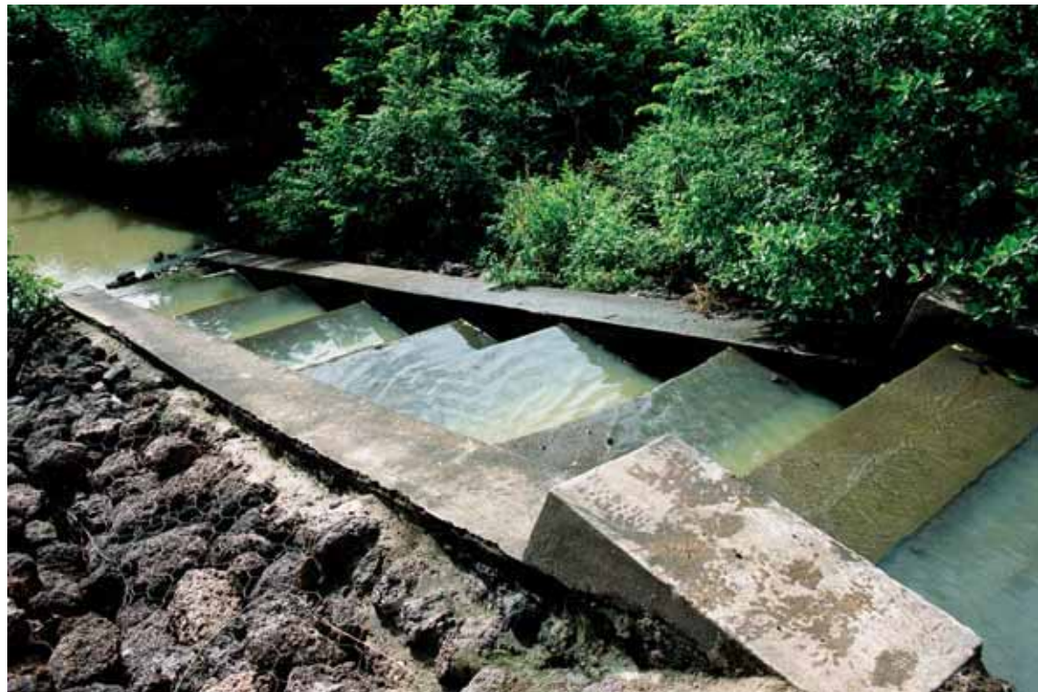
ຂັ້ນໄດປາສາມາດໃຫ້ປາເຄື່ອນຍ້າຍໄດ້ ເພື່ອກ່າຍຂັ້ນຕົວເຂື່ອນ ສຳລັບຊົນລະປະທານ (ຢູ່ເບີກິນາຟາໂຊ). ຂັ້ນໄດປາແມ່ນການປັບປຸງສິ່ງກໍ່ສ້າງທີ່ສຳຄັນ ເຊິ່ງສາມາດຮອງຮັບການປ່ອຍນ້ຳເພື່ອສິ່ງແວດລ້ອມ
